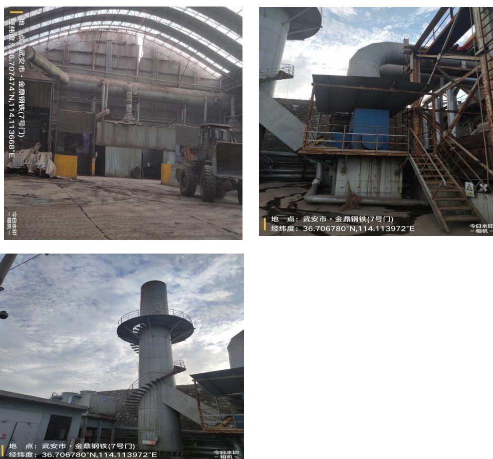
图 3-1 集气罩+除尘器+15m 排气筒
