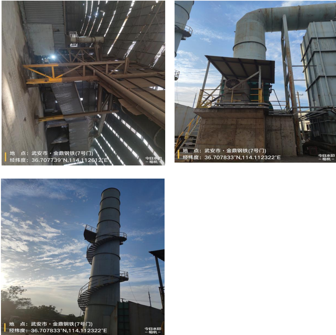
图 3-2 集尘罩+除尘器+15m 排气筒
